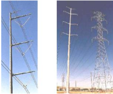
Fig. 28 HV and EHV lines.
